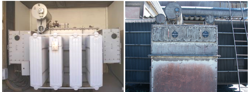
Exemplos de Janelas de segurança para inspeção termográfica instaladas na caixa de ligação dos transformadores (imagens do arquivo da JIT Brasil)
